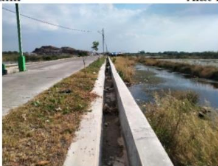
Drainase di Kawasan TPA
